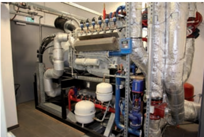
◀ Ein Gas-Blockheizkraftwerk produziert Strom und Wärme, aber auch Kühlung für die klimatisierten Räume des Rechenzentrums
